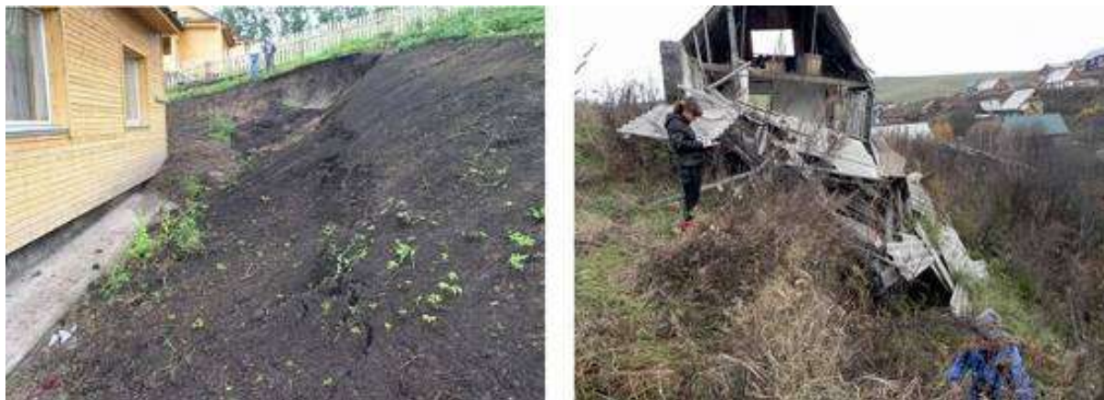
Рисунок 11.2 Последствия схода мелких оползней в г. Горно-Алтайске по ул. Черноплодной (2010 г.) и ул. Гагарина (2011 г.)
